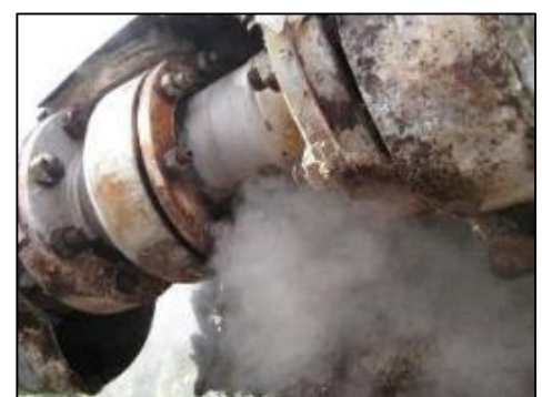
蒸気配管の不備
