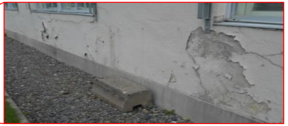
外壁のクラック
